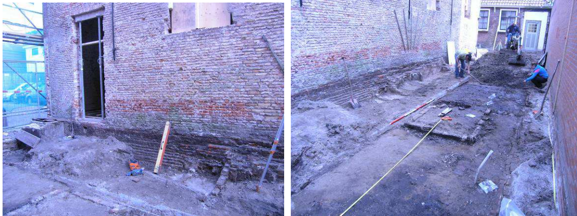
Afb.48a-b Details van de zuidgevel van de synagoge, gebouwd bovenop resten van Hofstraat 17
